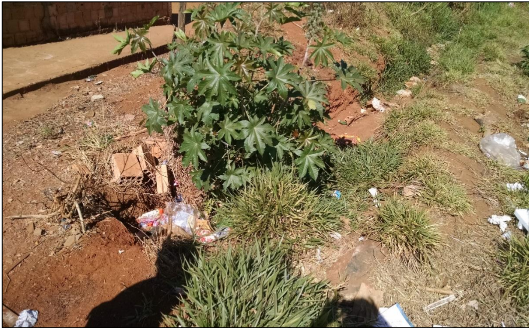
Figura 3.35 – detritos na tubulação de drenagem.
